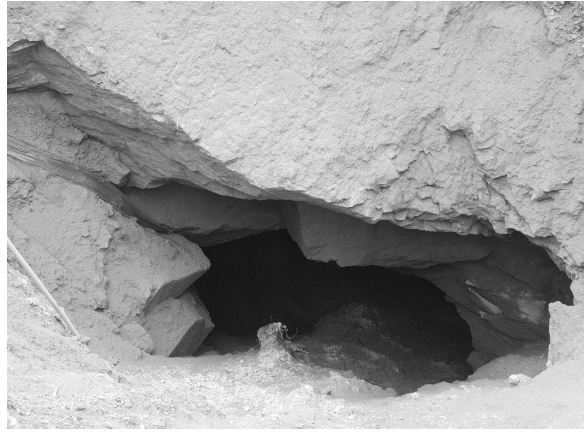
写真58 風化で劣化した笏谷石の破断口とその奥の空洞(坑道)
