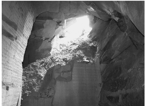
写真60 セツ尾口坑道内部より見上げた陥没地岩盤の破断口
