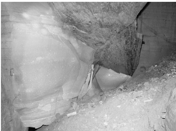
写真63 セツ尾口坑道内部の地獄谷を埋め尽くした陥没土砂(写真64と同じ位置)
