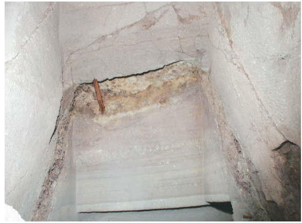
写真18 セツ尾口坑道内部にある笏谷石の断層破砕帯 (N60°E, 60°N)
