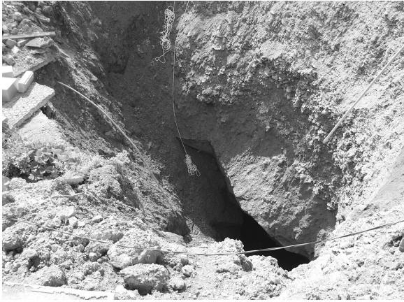
写真57 陥没穴底の岩盤の破断口
