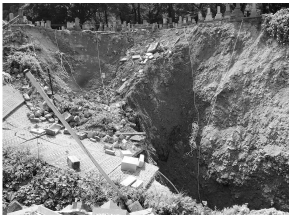
写真53 陥没直後の崩壊地周辺
