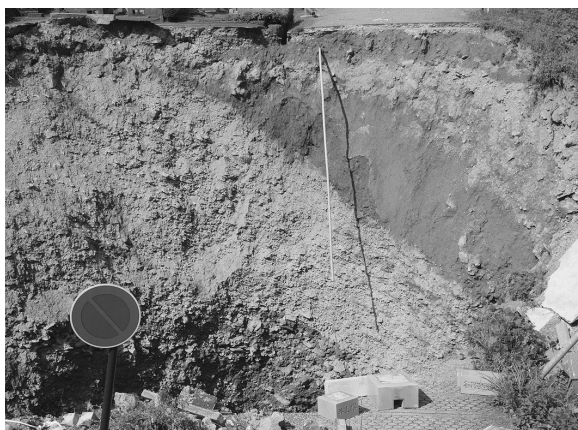
写真55 陥没地の垂直断面を見ると, 上部のほとんどは埋め土からなっている
